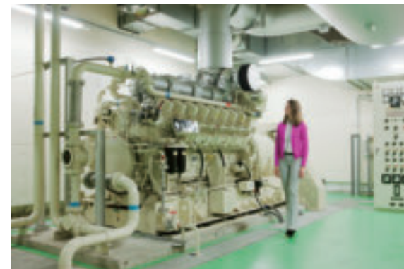
万一停電になった場合に稼働させる非常用発電機。
